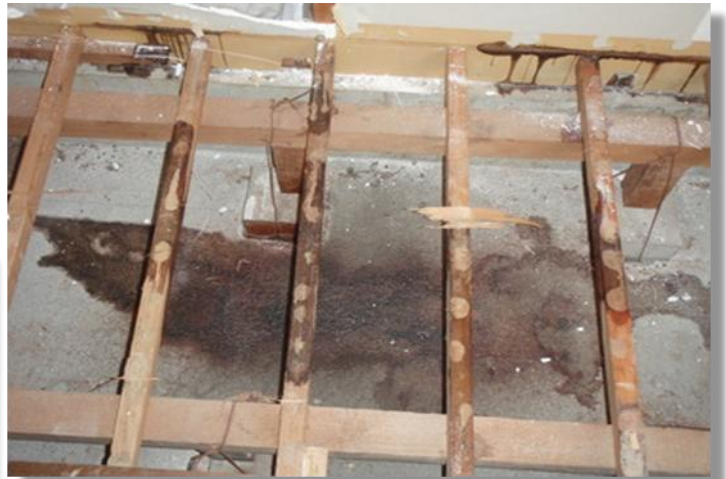
【体液は床のコンクリートまで浸透しています】
