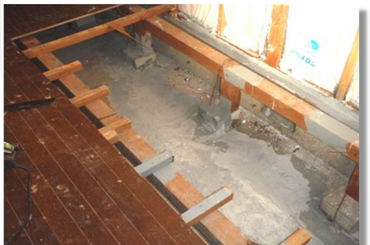
【浸透箇所のコンクリートを取り除き、特殊な消臭剤を用品す】
