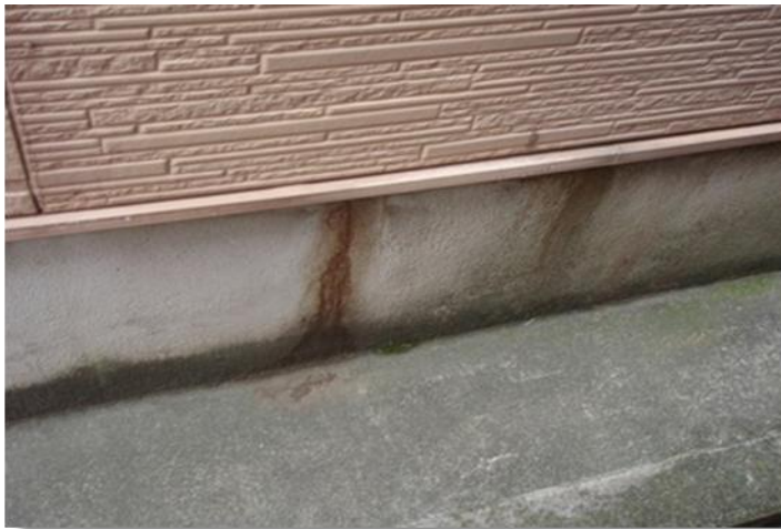
【基礎が割れていた場合には染み出てくることもあります】
